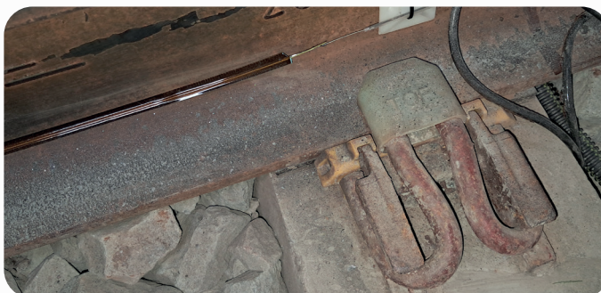
Fibre optique sur rail © SII
